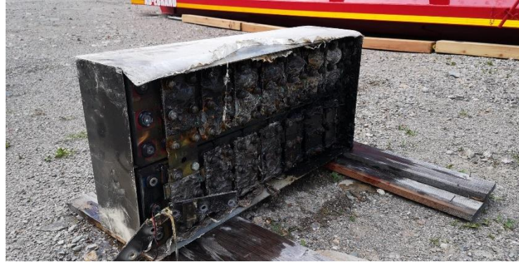
Quelle: FF Brixen, Brand eines stationären Speichers
